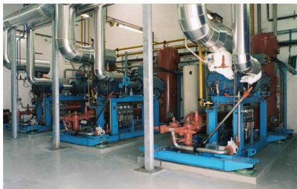
NH3 компрессор с VSD
